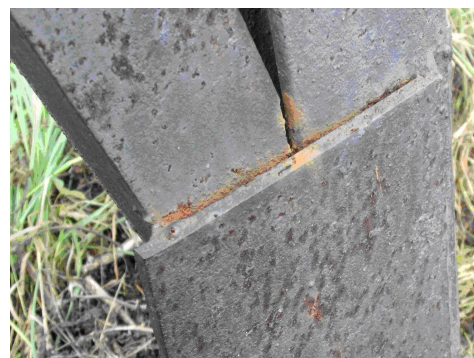
Рис.3 Места в косыночной части опоры, способствующие развитию щелевой коррозии металла (Опора № 81 стойка 3)
